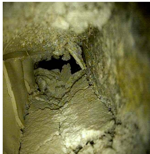
Endoskopieaufnahme (Videoskop) Injektionsmörtel weist Risse auf und hat an einigen Stellen keinen Verbund mit Putz und Mauerwerk
