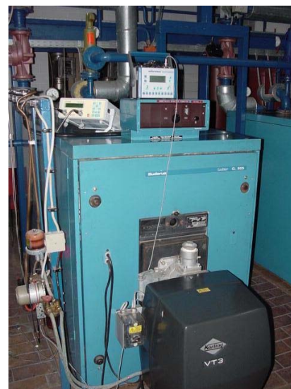
Heizkessel mit mobiler Messtechnik
