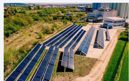
Solarthermieanlage Marbach, © SWE Energie GmbH
