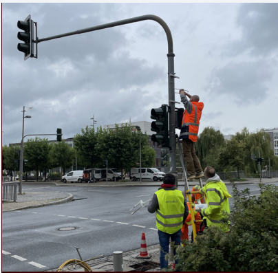
Installation von Sensoren am Knotenpunkt Maximilian-Welsch-Straße/Theaterplatz. Foto: Juri Golanov
